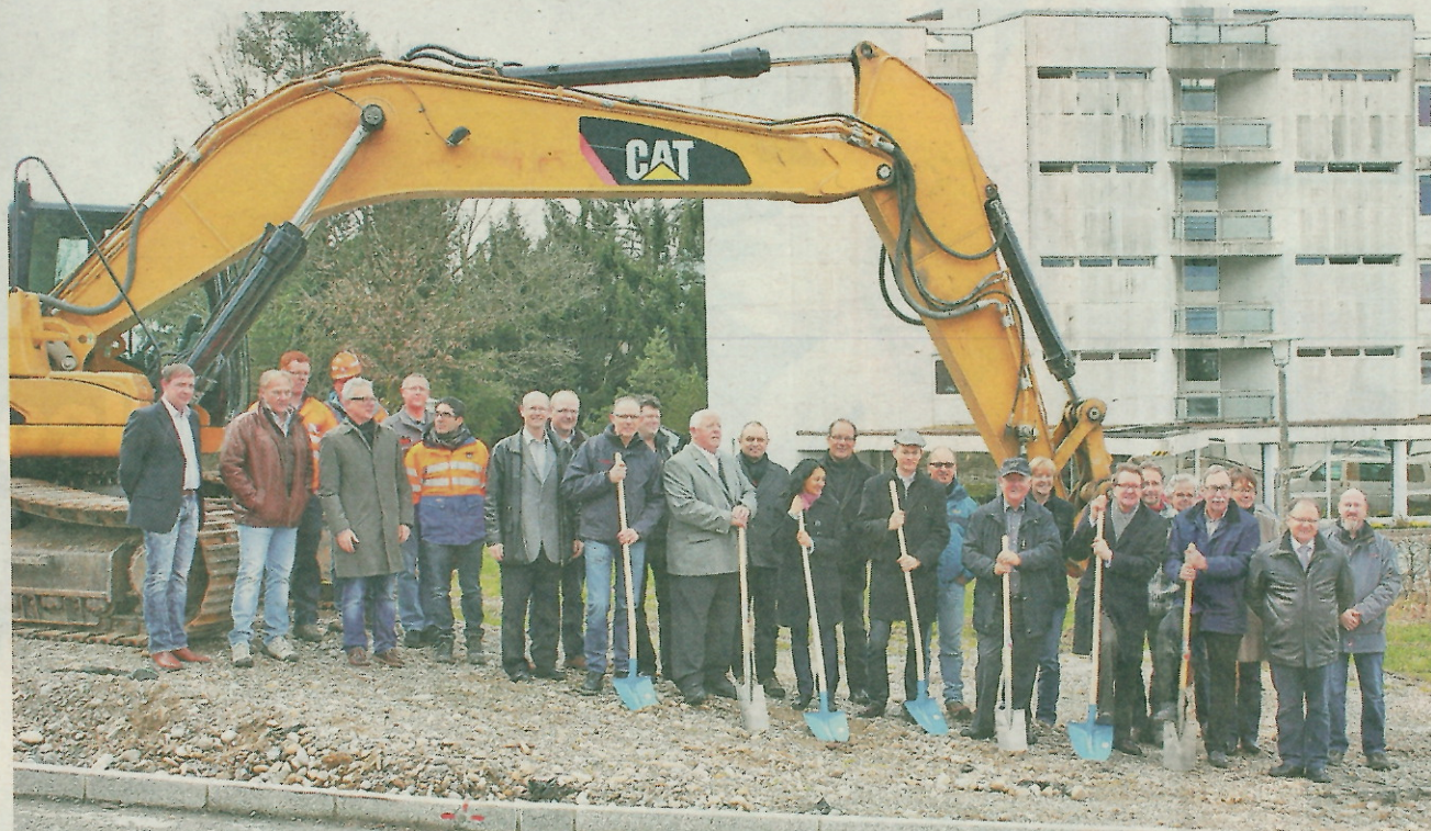
Ran an die Spaten: Danach rechnet man mit einer Bauzeit von ca. 12 bis 14 Monaten Die Wohnungen sollten somit im Frühling 2015 zum Bezug bereit stehen.
